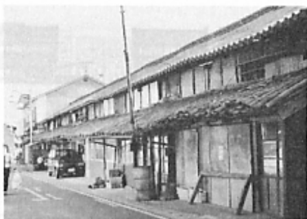
老朽化が進む十軒長屋、2階の階高は低い。
